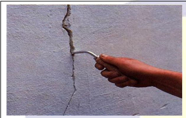
Fig. 08. Abertura da trinca
