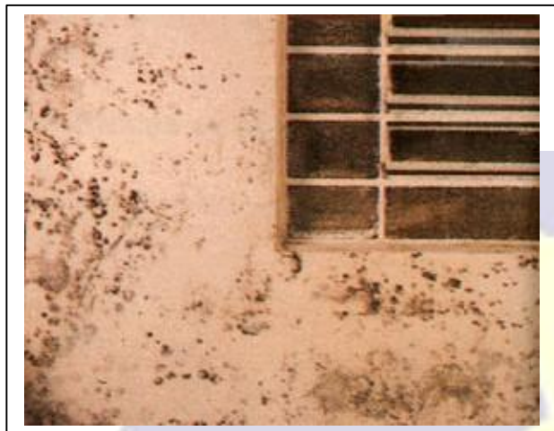
Fig. 12. Mofo, Bolor ou Fungos
