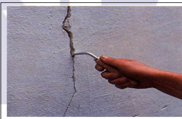
Fig. 08. Abertura da trinca
